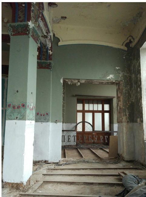
Рис. 50. Фрагмент интерьера: в углу и на потолке зона протечки, неудовлетворительное состояние трафаретной живописи, демонтировано покрытие пола (Санкт-Петербург, Загородный пр., д. 52; автор фото К. Ю. Губинская, 2017 г.)
