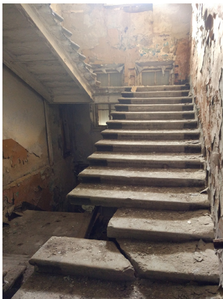
Рис. 48. Каменная лестница по металлическим косоурам, аварийное состояние элементов лестницы, отсутствует ограждение, лестничная клетка в целом в неудовлетворительном состоянии (Санкт-Петербург, Щепяной пр., д. 4–6; автор фото К. Ю. Губинская, 2019 г.)
