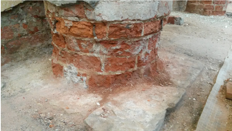
Рис. 35. Неудовлетворительное состояние колонны в нижней цокольной части объекта, деструкция и обрушение кирпичной кладки, отсутствие отмостки, основание колонны скрыто культурным слоем (Санкт-Петербург, ул. Союза Печатников, д. 22; автор фото К. Ю. Губинская, 2016 г.)
