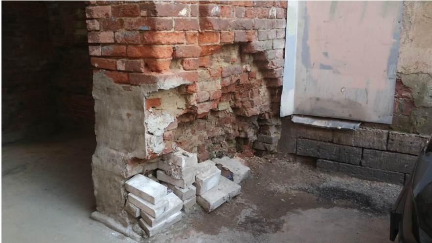
Рис. 37. Неудовлетворительное состояние нижней части здания, вывал кирпичной кладки (Санкт-Петербург, наб. р. Мойки, д. 82; автор фото К. Ю. Губинская, 2018 г.)
