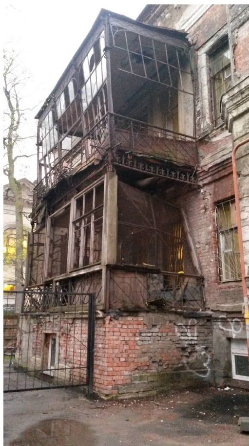
Рис. 47. Исторический балкон-веранда, неудовлетворительное и аварийное состояние несущих конструктивных элементов, декоративного оформления металлоконструкций (Санкт-Петербург, Английский пр., д. 4–6; автор фото К. Ю. Губинская, 2016 г.)
