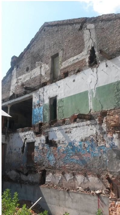
Рис. 39. Неудовлетворительное состояние кирпичной кладки внутренней несущей стены с множественными дефектами, включая трещины, деструкцию кирпичной кладки, утрату штукатурного и красочного слоев (Санкт-Петербург, Садовая ул., д. 62; автор фото К. Ю. Губинская, 2015 г.)
