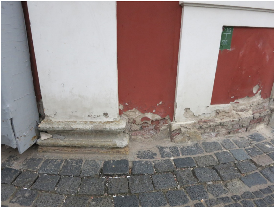
Рис. 36. Неудовлетворительное состояние нижней части здания, дефекты камня, кирпичной кладки, штукатурной отделки и красочного слоя (Санкт-Петербург, ул. Пестеля, д. 2а; автор фото К. Ю. Губинская, 2020 г.)
