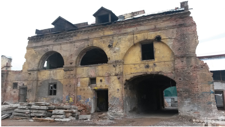
Рис. 38. Неудовлетворительное состояние кирпичной кладки лицевой фасадной стены объекта архитектурного наследия с множественными дефектами, включая трещины, деструкцию кирпичной кладки, утрату штукатурного и красочного слоев (Санкт-Петербург, Садовая ул., д. 62; автор фото К. Ю. Губинская, 2015 г.)
